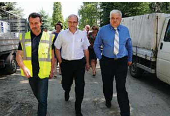
Członek zarządu spółki Paweł Łodej, radny Stanisław Altenberg, burmistrz Romuald Garczewski wizytują plac budowy
