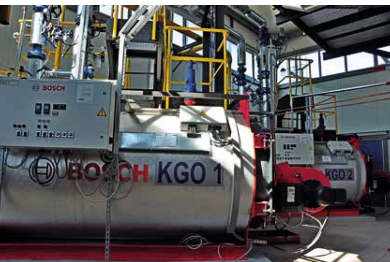
Instalacje w Zakładzie Energetyki Ciepłej
