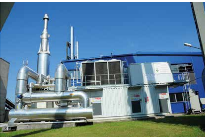
Zakład Energetyki Ciepłej w Staszowie
