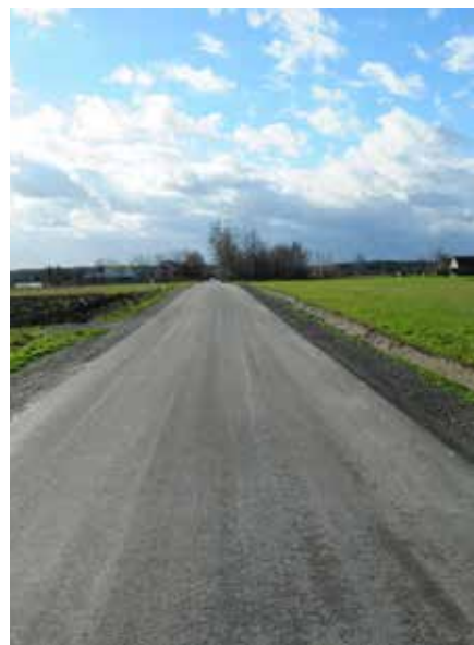
Przebudowa drogi gminnej nr 003722T w Krzczonowicach (782 mb). Wartość zadania: 161 737,15 zł , dofinansowanie 109 038,00 zł .
