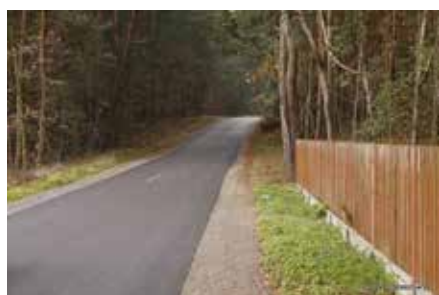
Przebudowa drogi gminnej Wólka Żabna – Podmaleniec. Łączna długość wyremontowanych odcinków to 2068 m. Wartość inwestycji wyniosła: 301 716 zł
