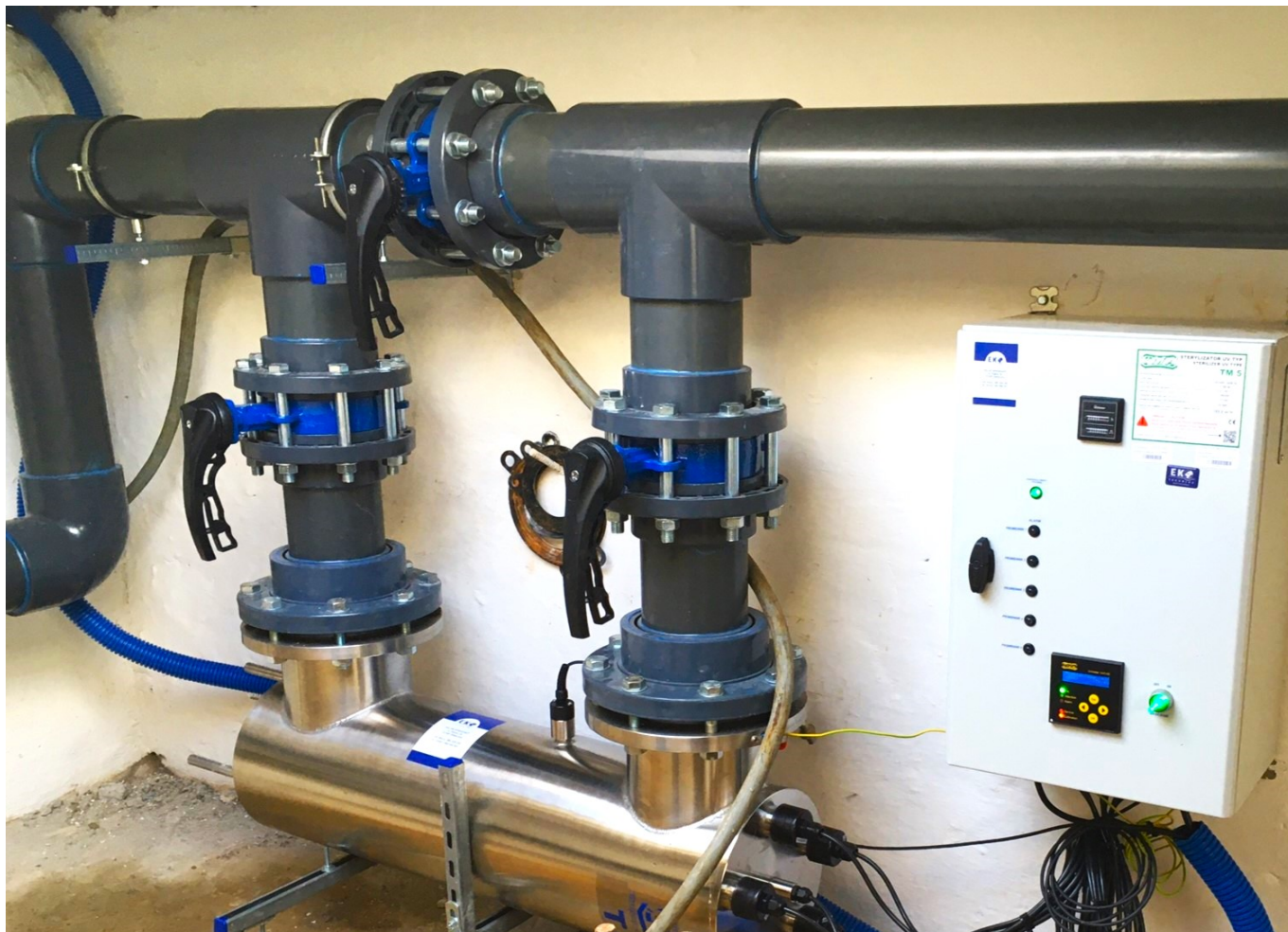
Lampa UV Pompownia nr 1 ujęcie Radzików II
